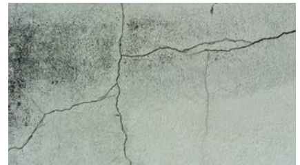
grosse Schwindrisse im abgebindenen Zustand
