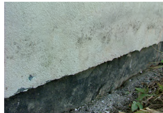
Zone du soubassement
