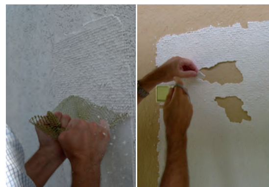
Photo gauche : support porteur Photo droite : support insuffisamment porteur
