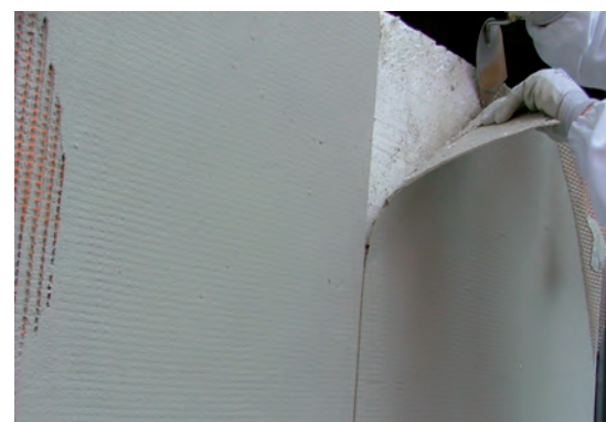
Détachement de l'enduit des panneaux EPS
