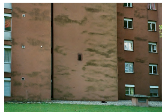
Façades pénétrées d'humidité avec algues
