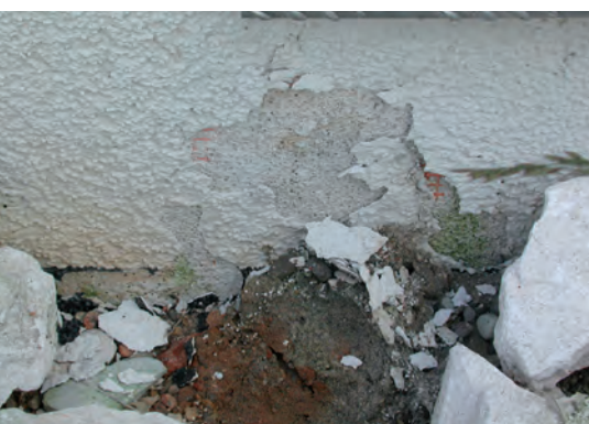
Zone du soubassement
