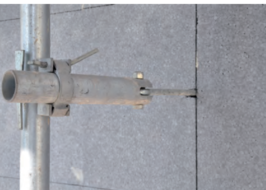
Ancre de l'échafaudage
