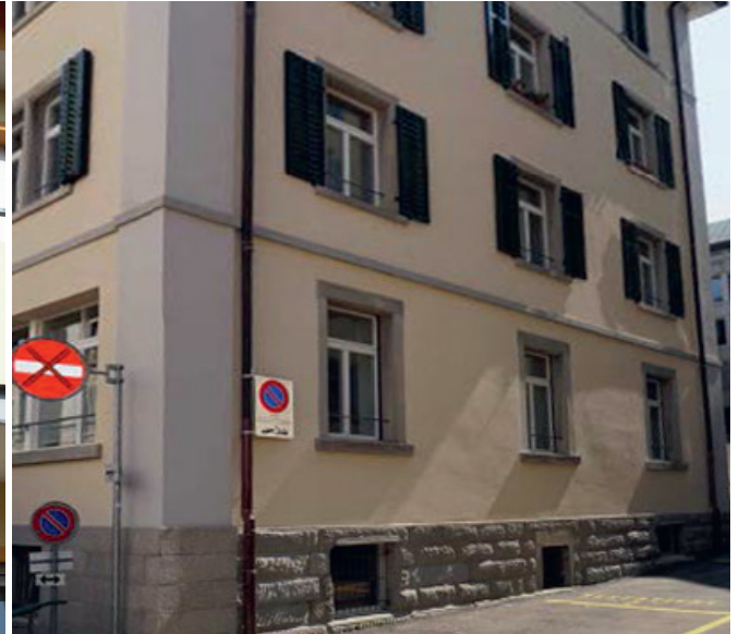
Streiflicht auf der Fassade mit Aerogeldämmputz; die Dämmung ist auf dieser Fassade nicht sichtbar.
