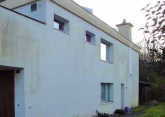
Fassade mit Algenbewuchs
