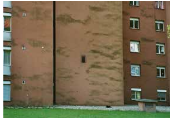
Durchnässte Fassade mit Algenbewuchs
