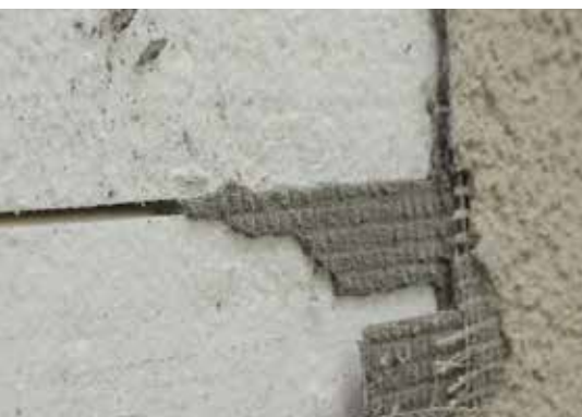
Mörtel im Plattenstoss
