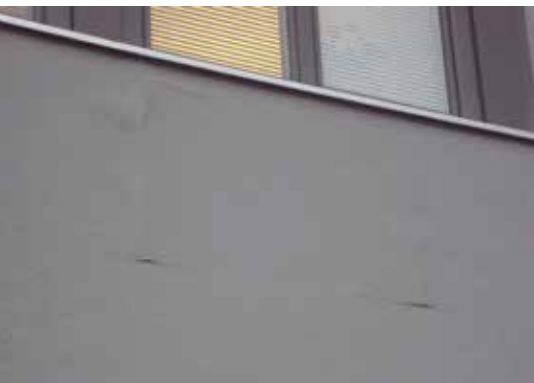
Risse und Putzaufwölbungen im Plattenstoss
