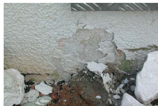
Par l'effet du gel, l'humidité dans la zone du socle cause des dégâts dans le crépi
