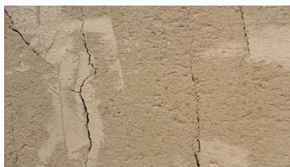
Fissures de retrait sur la couche fraîche
