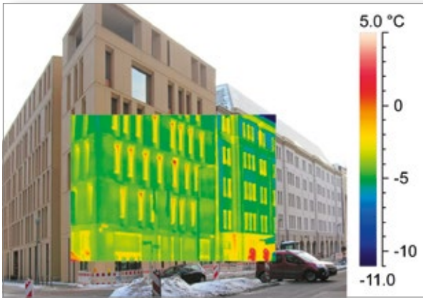
Thermografie der Straßenfassade von Alt- und Neubau des BMUB in Berlin zur Überprüfung der Ausführungsqualität
